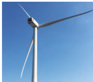
図1 | 5 MW風力発電実証機の 外観
