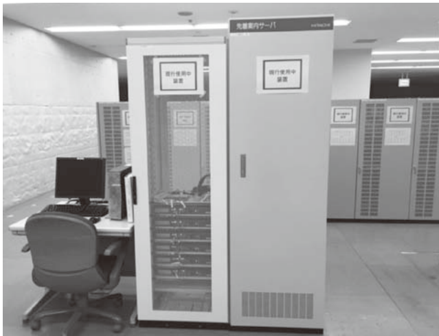
図4 | 先着案内サーバ・監視入力端末の設置の様子 中央システムの先着案内サーバ、監視入力端末の外観を示す。
