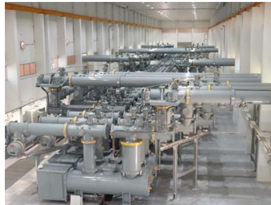
3 Chaiyaphum 2変電所向け550 kV GISの全景
