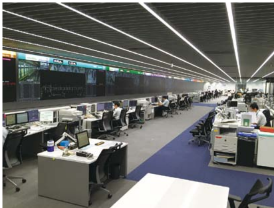
4 東京地下鉄総合指令所指令室
