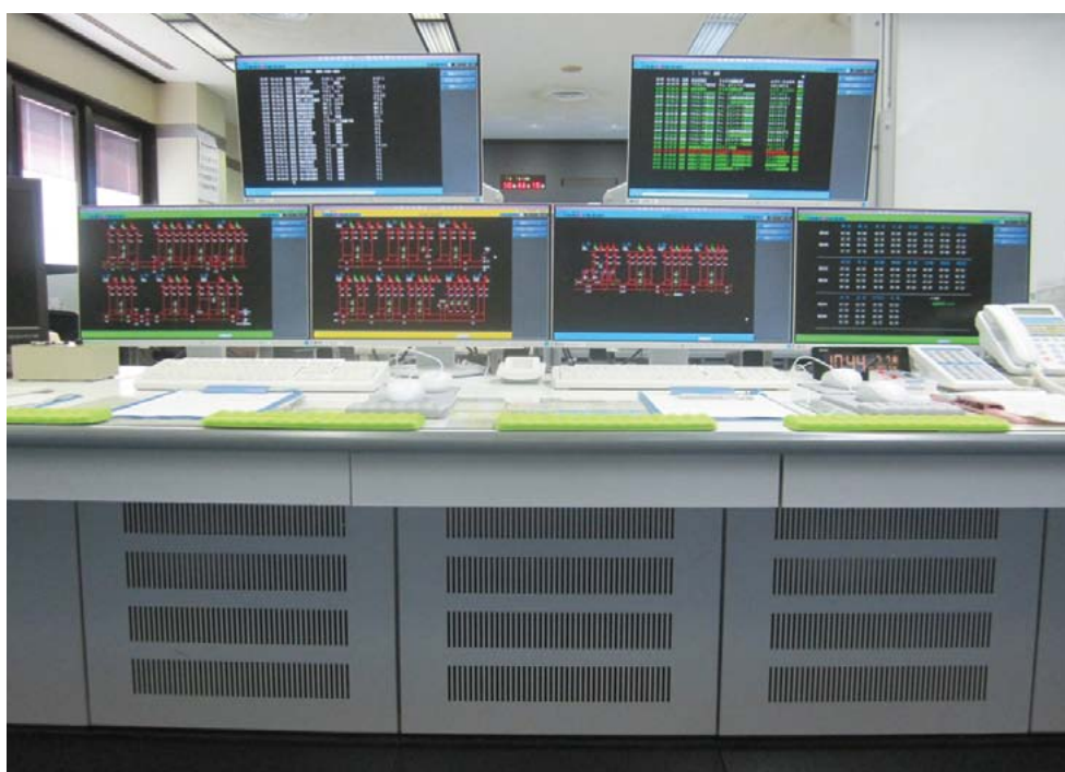
7 札幌市交通局電力管理システムの中央システム指令卓
