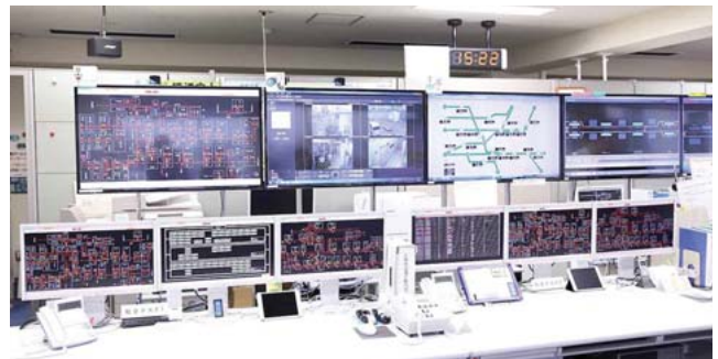
2 東京急行電鉄 電力管理システムの中央システム司令卓
