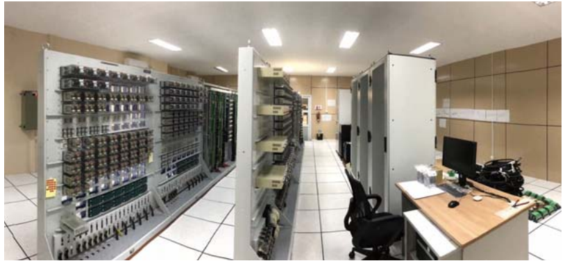
1 ヤンゴン中央駅 新機器室
